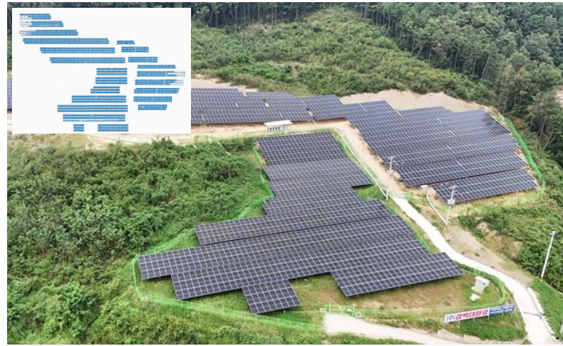
나대지 1.4MW (경북 상주, 2023 준공)
